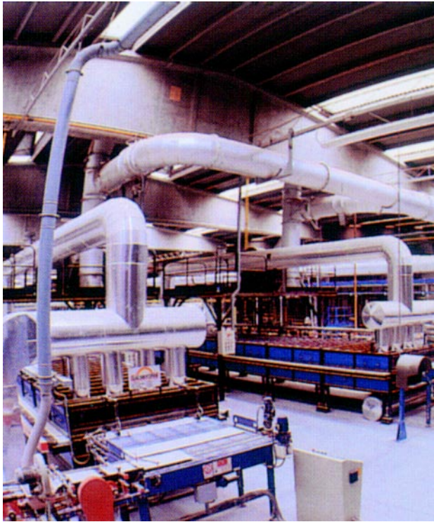
I moderne flisproduksjon er det stor grad av automatisering
