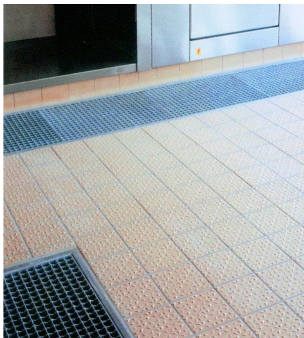
Flisoverflate med dreneringsrom
